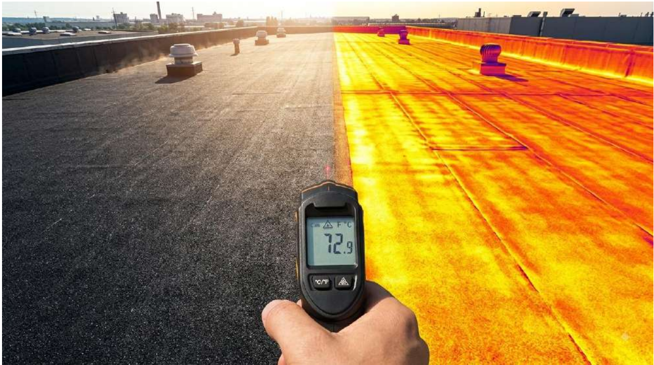
An einem Sommertag erreicht eine dunkle Bitumenbahn 70 bis 85 °C an der Oberfläche. Eine Thermografie zeigt diese angesammelte, mit bloßem Auge unsichtbare Wärme sofort. (KI-generiertes Bild)
